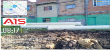
Fotografía No. 7 Tubería que iba a ser instalada
