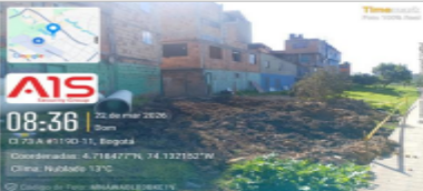
Fotografía No. 9 Remoción de suelo, pérdida de cobertura vegetal
